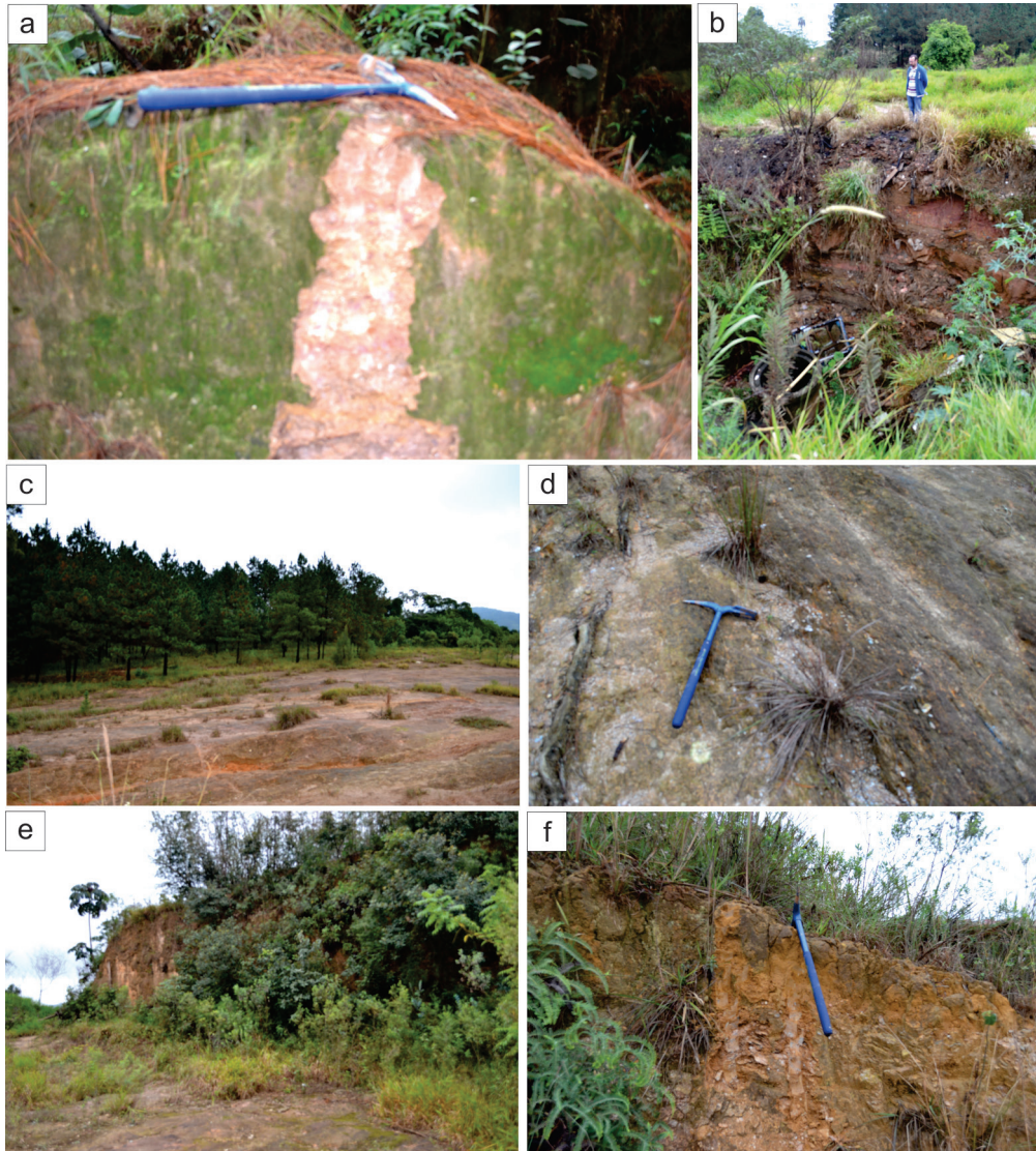
FIGURA 5 – Terrenos tecnogênicos caracterizados no quadro 1: a) material constituinte do terreno tecnogênico de agradação 1 (depósito tecnogênico construído espólico); b) material tecnogênico estratificado misto constituinte da planície tecnogênica; c) em primeiro plano, exposição da alterita de rocha metamórfica do terreno tecnogênico de degradação; d) detalhe dos sulcos de erosão desenvolvidos paralelamente à foliação principal reliquiar da alterita; e) talude de corte do terreno de degradação; f) solum raso remanescente de terreno original.
